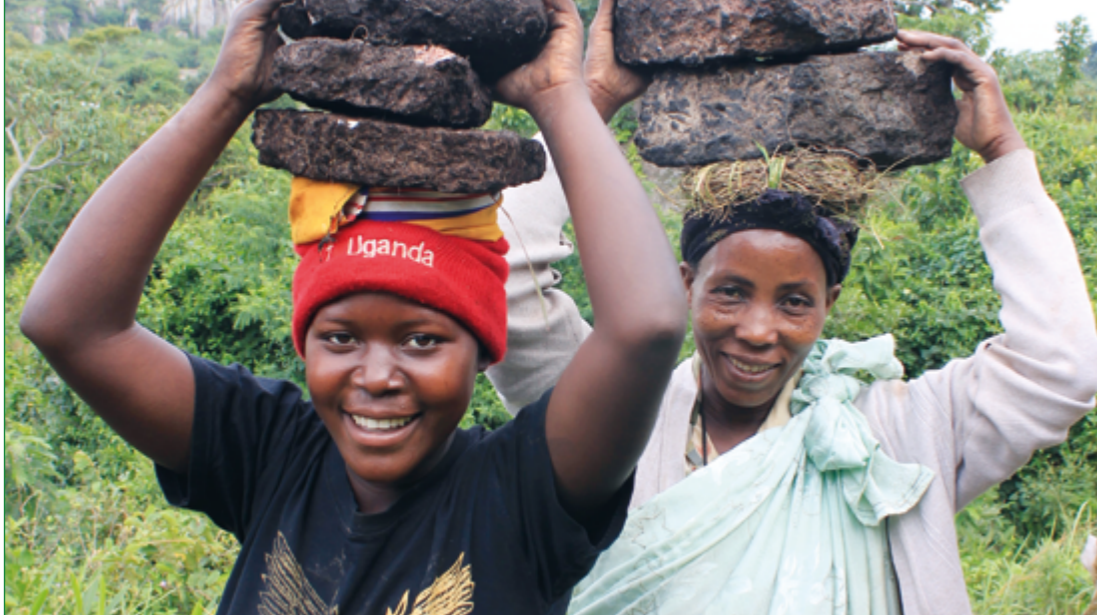
Bei den Infrastruktur-Projekten packen die Menschen vor Ort gerne mit an, hier beim Bau des Kooki Hospitals.
